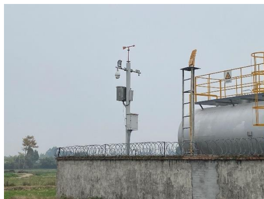
安装了监控设备
