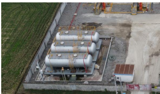
污水罐及围堰
