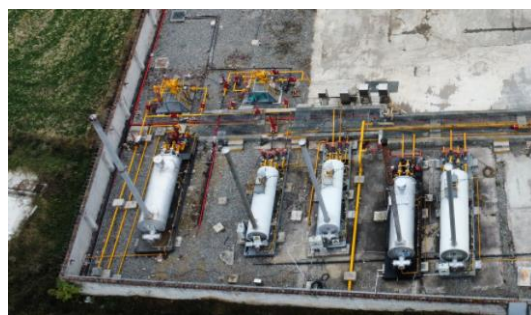
水套炉自带排气筒
